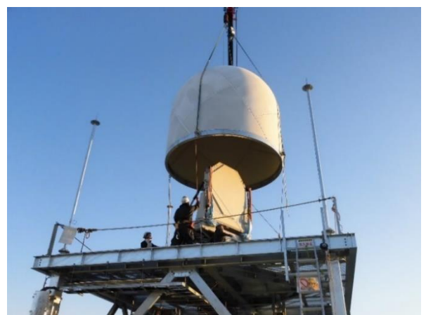
MP-PAWR 埼玉大学設置時の様子 （アンテナにレドームを被せる直前）
